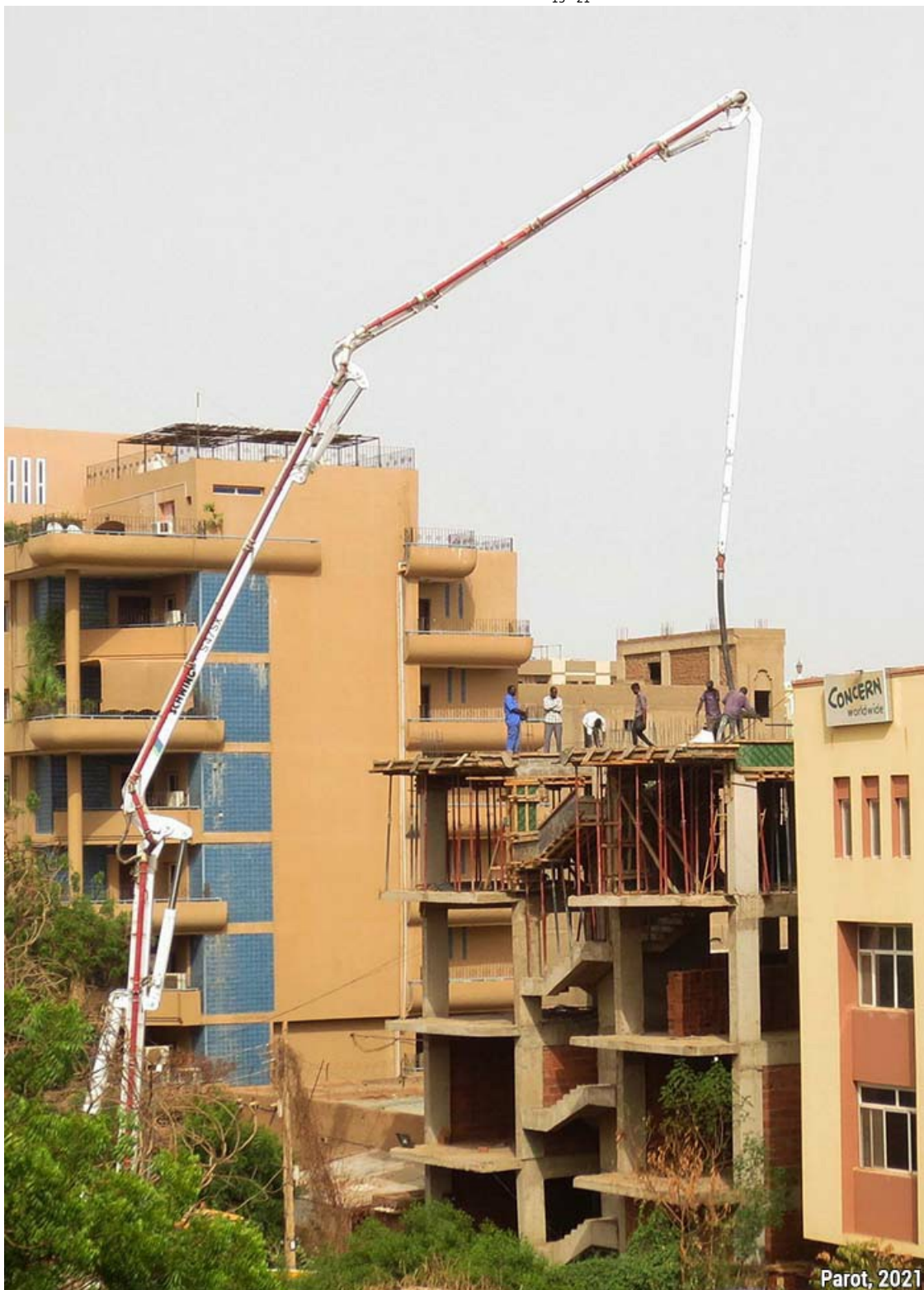
Document 13. Des ouvriers travaillent sur le toit d'un immeuble d'habitation en construction à Khartoum. Cliché de Noé Parot, 2021. Localisation : 15°35'35.3"N 32°31'59.8"E .
