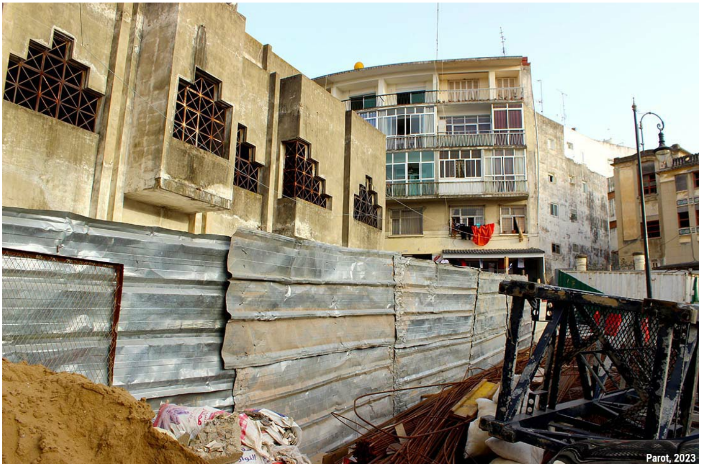
Document 15. Les débris de chantier s'installent dans tous les espaces de la ville, ici à Tanger. Cliché de Noé Parot, 2023. Localisation : 35°46'56.7"N 5°48'37.7"W .
